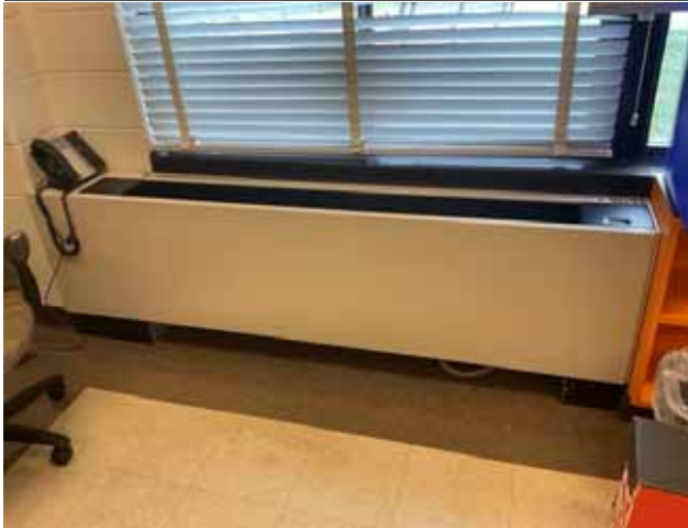
31 - FAN COIL UNIT
